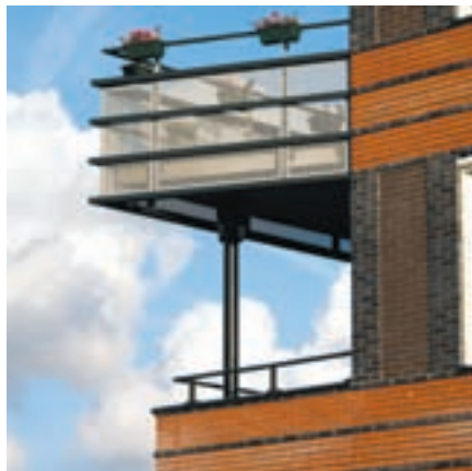
Nootdorp, Meidoornlaan. De horizontale sierregels van het hekwerk lopen door in de speklagen van het gevelmetselwerk
